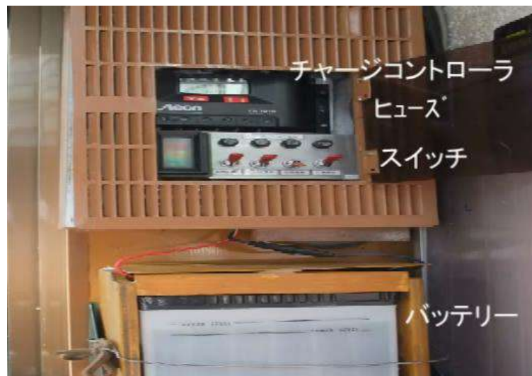
常設の場合は、要所にフューズを入れて配線を保護する
