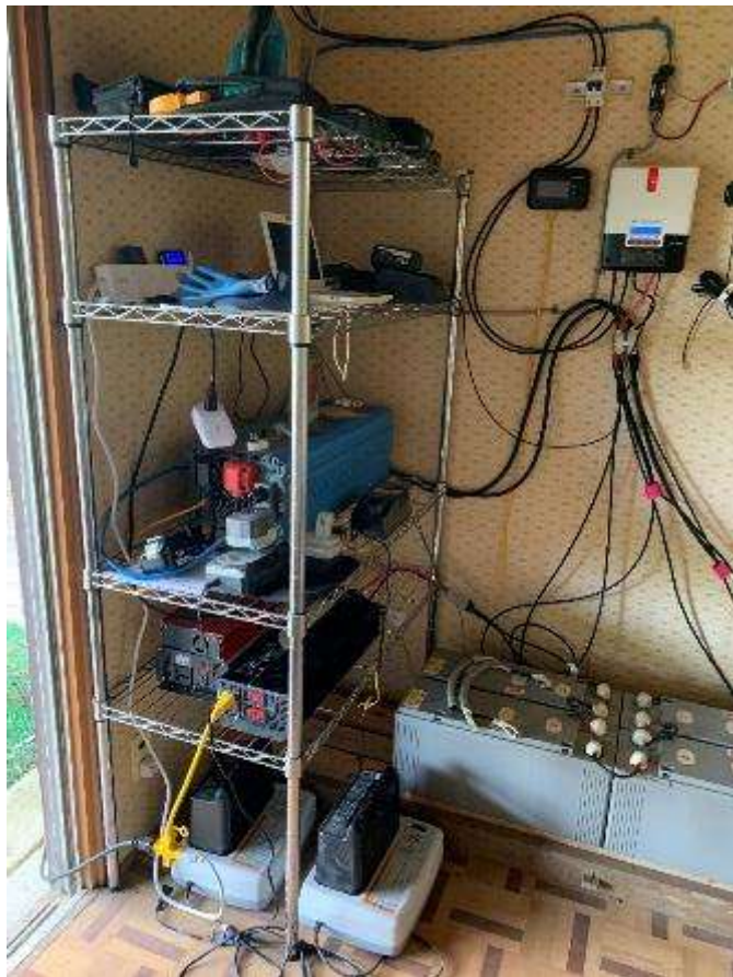
非常用インバータに切り替え ドラムリールケーブル引き込み
